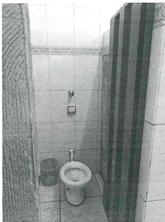
Descarga não funciona corretamente.
