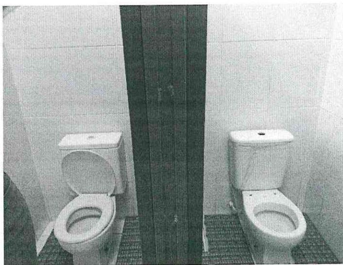
Banheiros com mal funcionamento das descargas devido ao problema da rede de esgoto.
