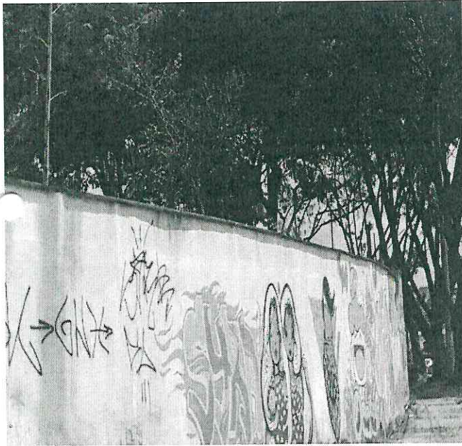
5. Parte do muro sem concertina.
