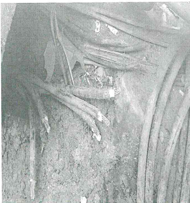
3. Cabos elétricos cortados e retirados da caixa de distribuição.
