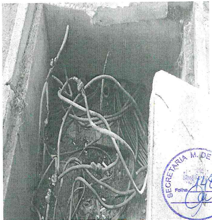
4. Cabos elétricos cortados e retirados da caixa de distribuição.
