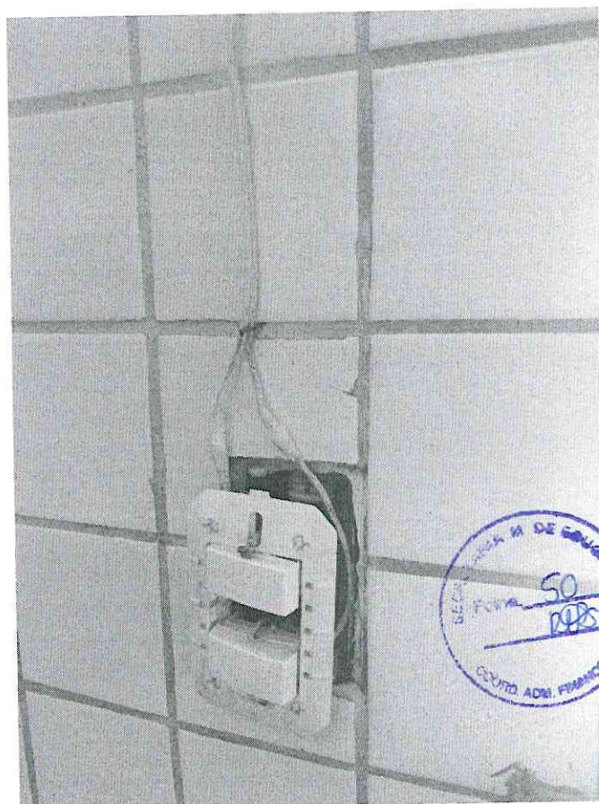
Figura 4: Fiação do interruptor da sala de aula
