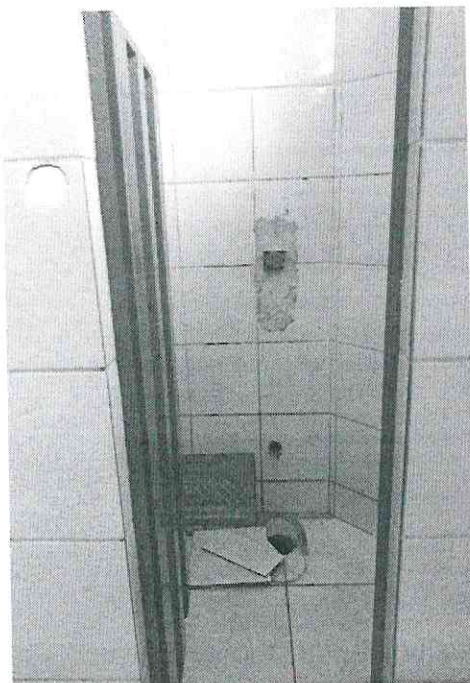
Figura 13: Ausência do sanitário.
