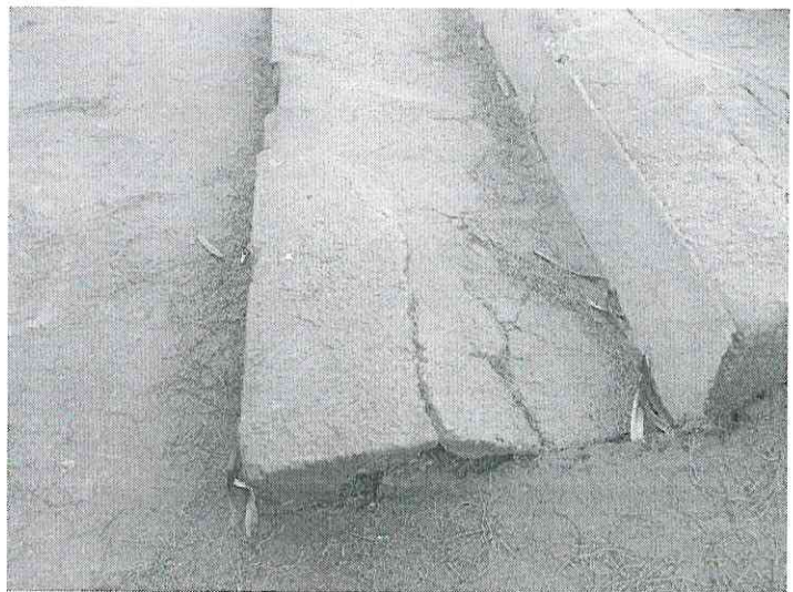
Figura 12: Patologia na arquibancada.
