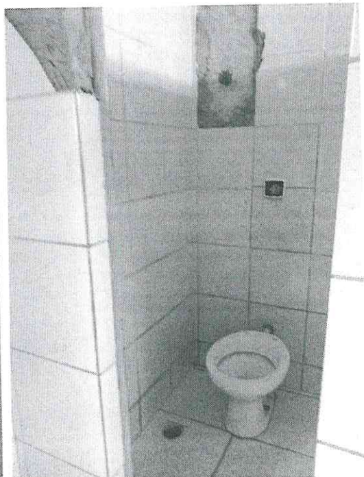
Figura 14: Ausência azulejo e ralo.
