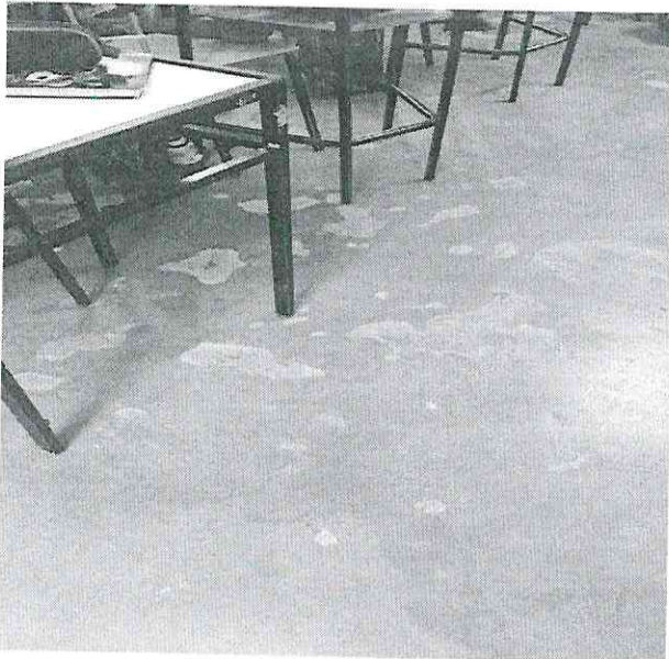
3. Pisos de salas danificados.
