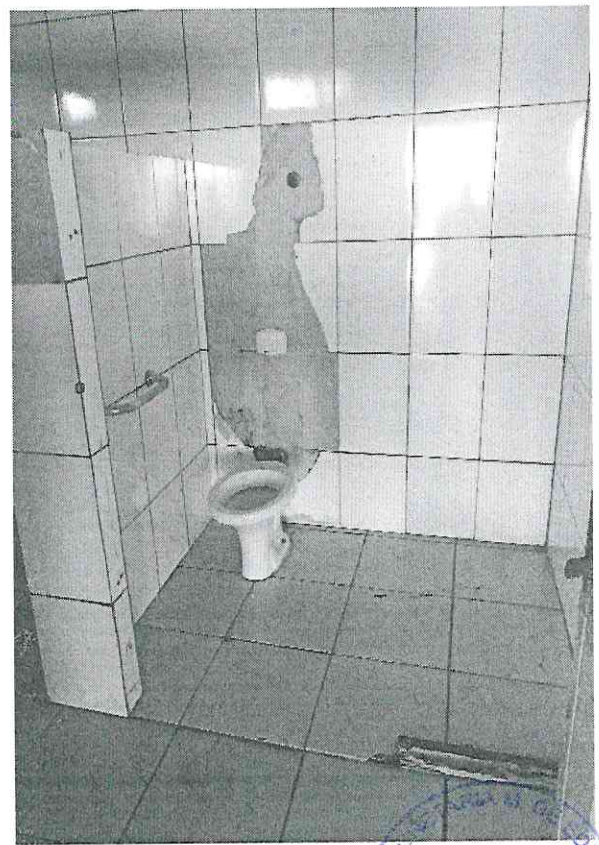
2. Banheiro dos estudantes - não conta válvula e tubulação.
