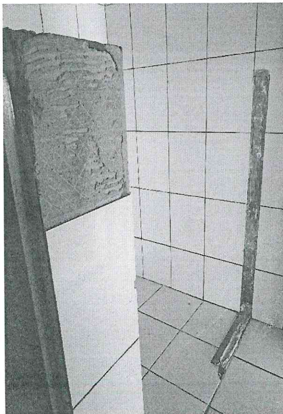
1. Banheiro dos estudantes – desprendimento de cerâmicas
