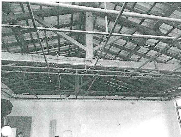
Figura 14: Rede elétrica da escola
