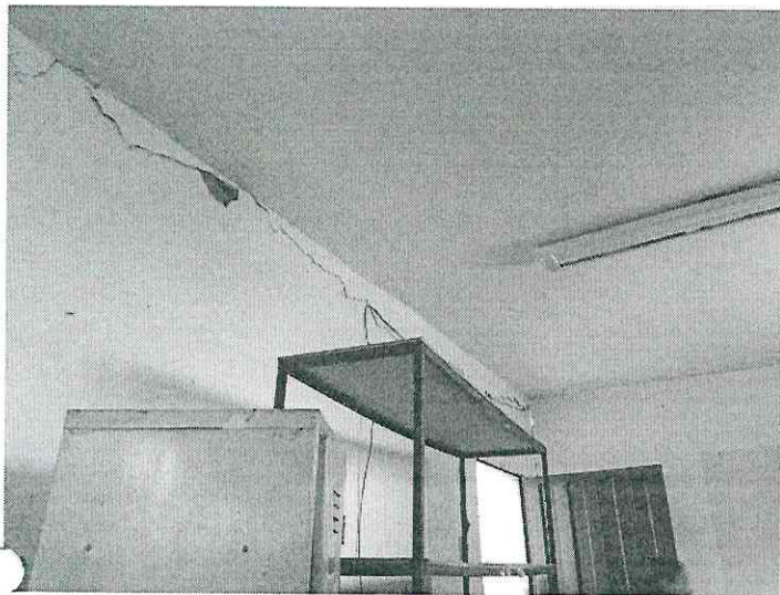
Figura 18: Depósito será demolido e reconstruído
