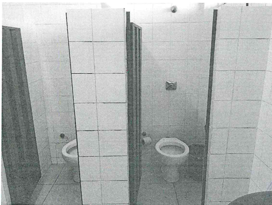
Figura 6: Box do banheiro.
