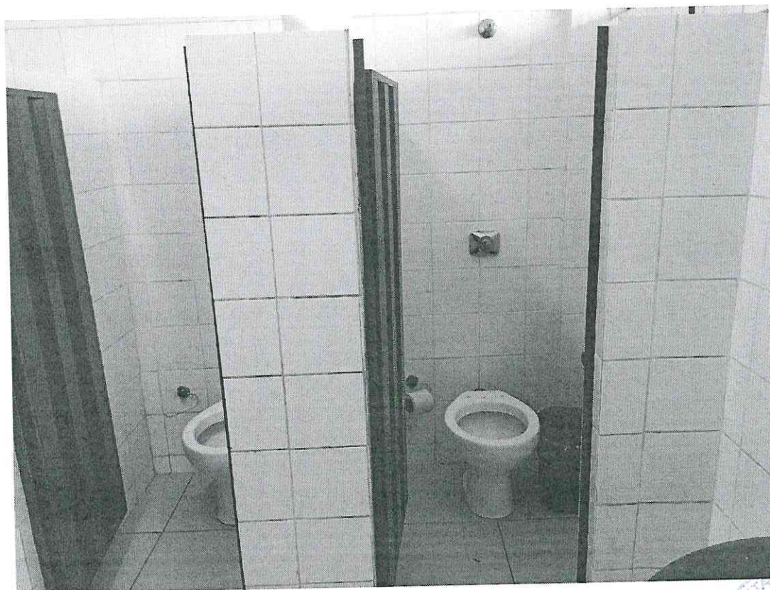
Figura 6: Box do banheiro.
