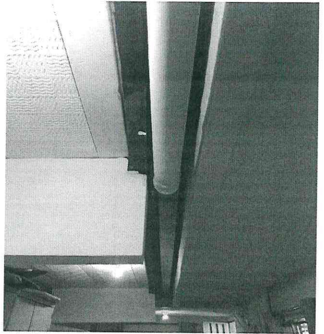
6. Interior da sala de impressoras.
