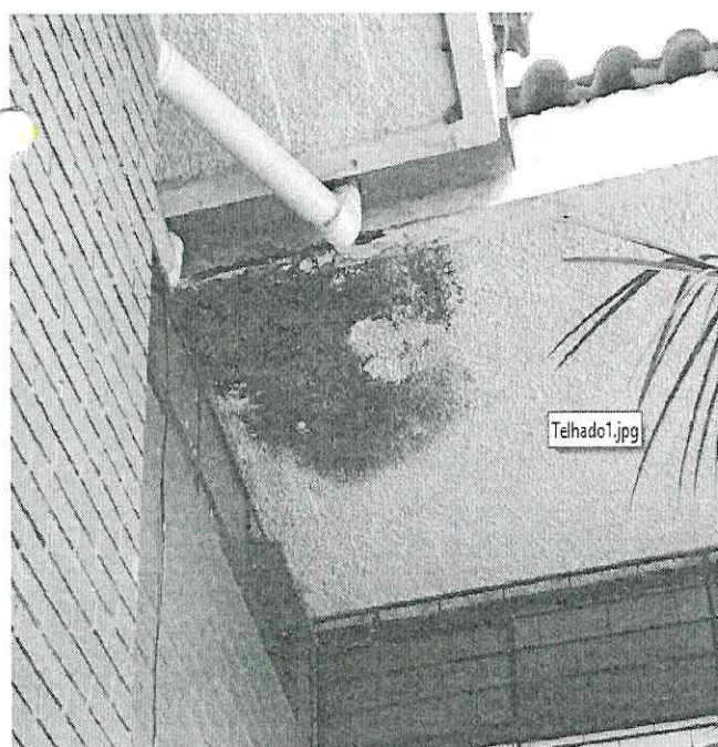
Figura 2: Infiltração por vazamento do telhados
