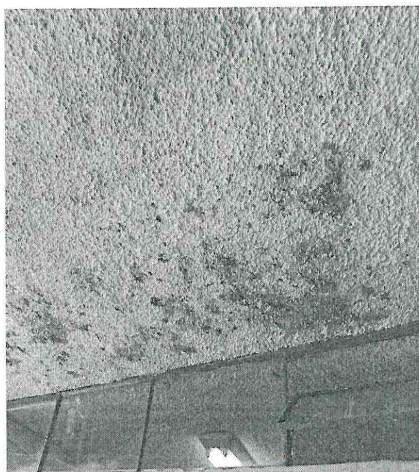
Figura 3: Infiltração por vazamento do telhado
