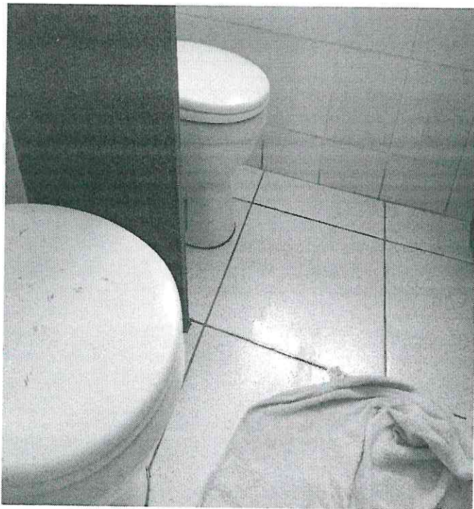
10. Vazamentos nas bases dos vasos.
