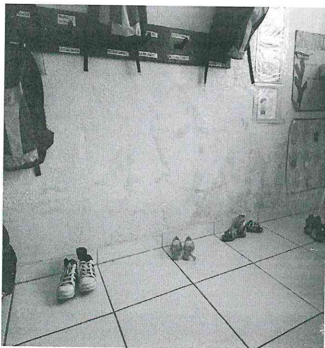
12. Infiltração nas paredes.
