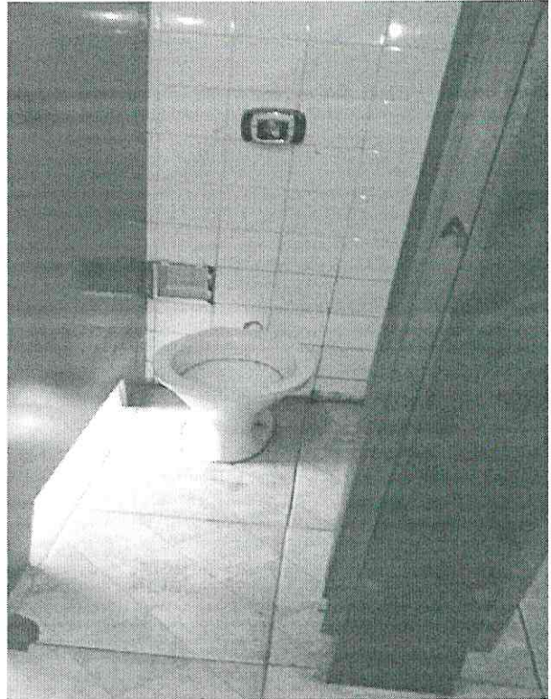
6. Banheiro dos alunos – ausência de válvula de descarga.
