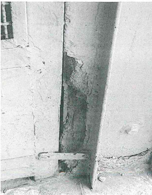
7. Pilar do refeitório – desgaste e ferrugem.
