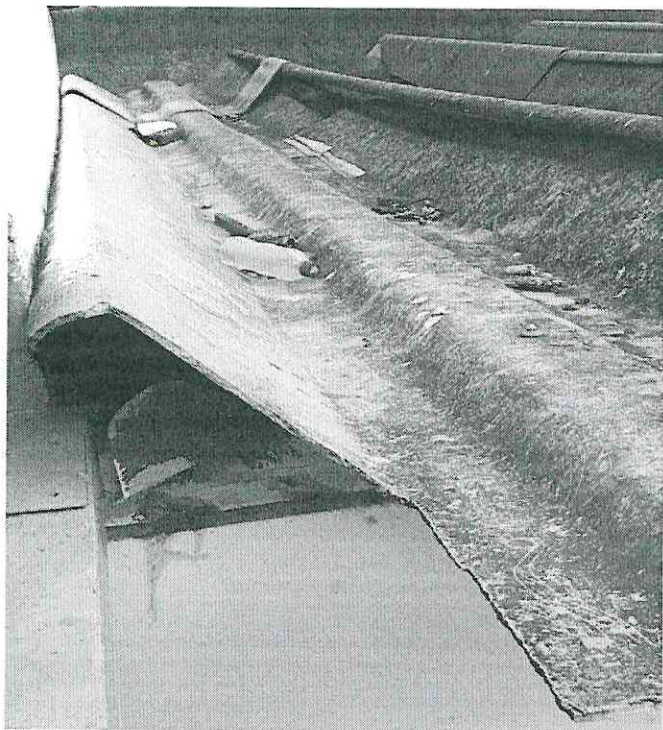
1. Telhado – telhas quebradas.
