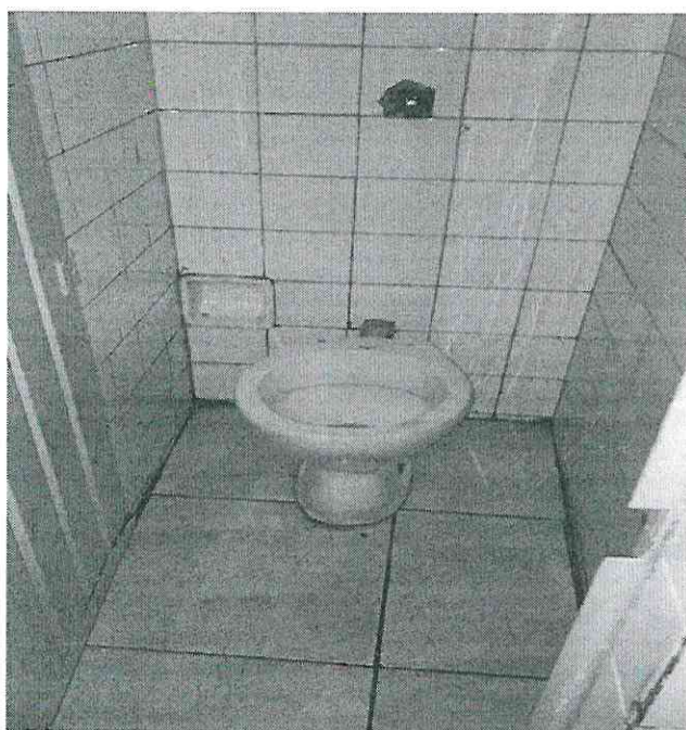
3. Banheiro - cerâmica e vaso manchados e desgastados.
