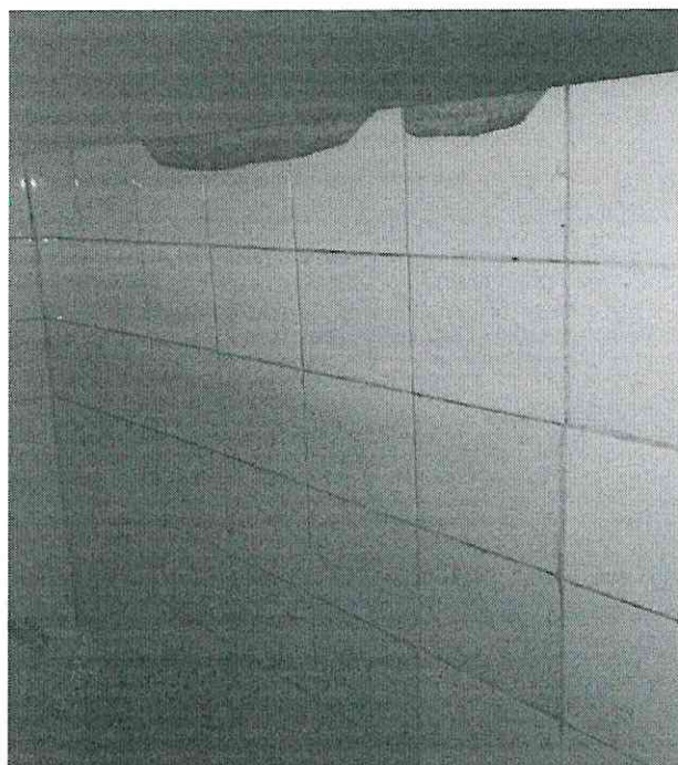
2. Banheiro – azulejos quebrados.
