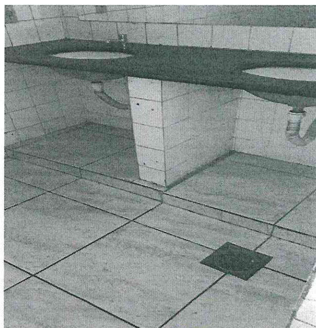
4. Banheiro – degrau para acesso aos lavatórios.
