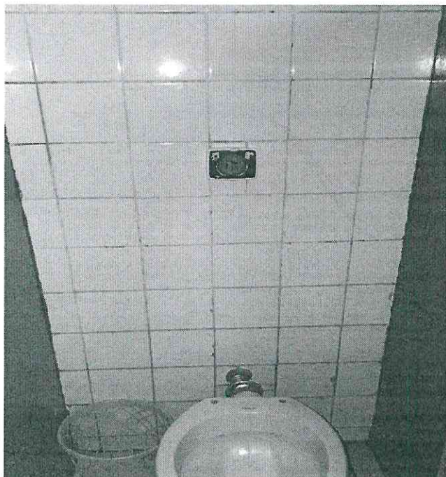
1. Banheiro – falta válvula de descarga.
